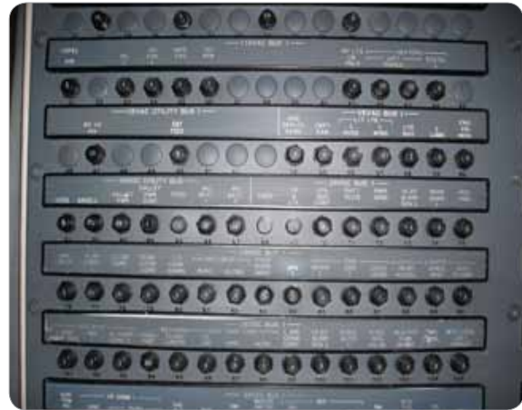
[그림 2-158] Circuit breaker panel
