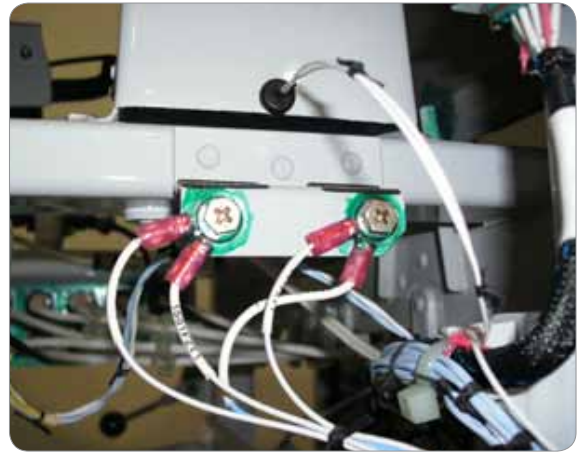
[그림 2-131] Ground wires
