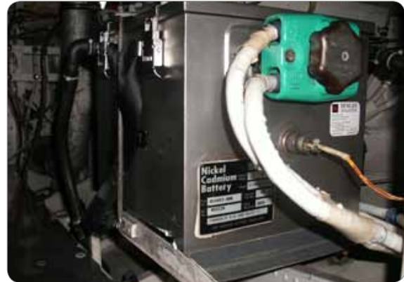
[그림 2-34] NiCd battery installation
