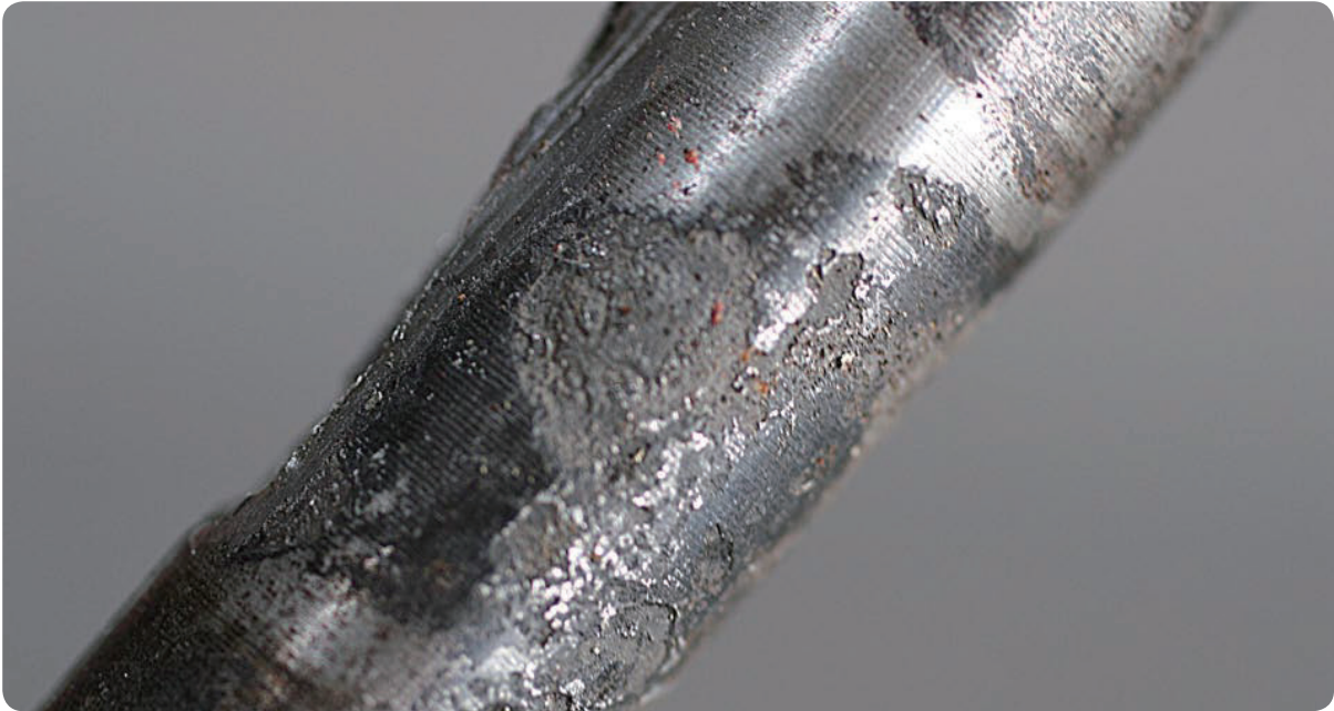
[그림 6-6] Dissimilar metal corrosion
