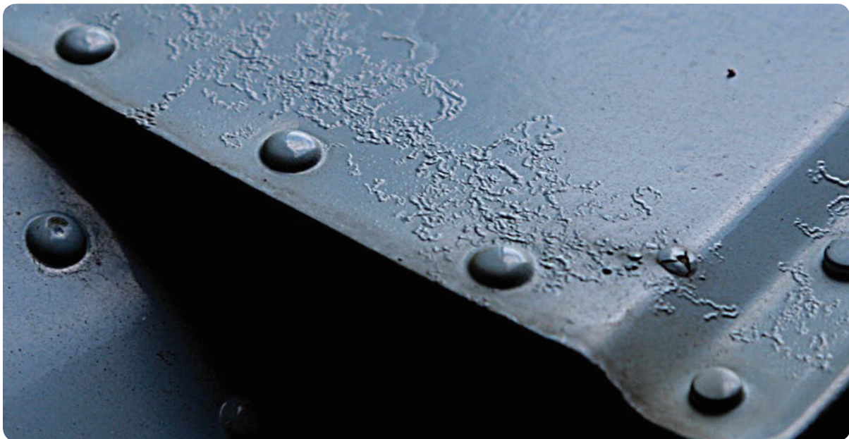
[그림 6-5] Filiform corrosion
